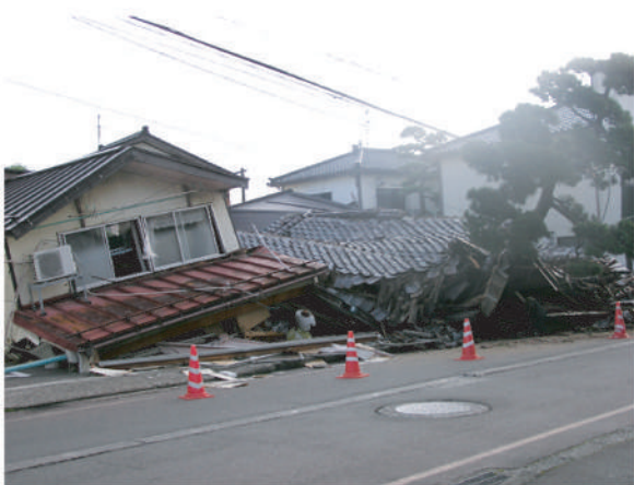
「えんま通り」近くの民家。一階が押し潰されています。
